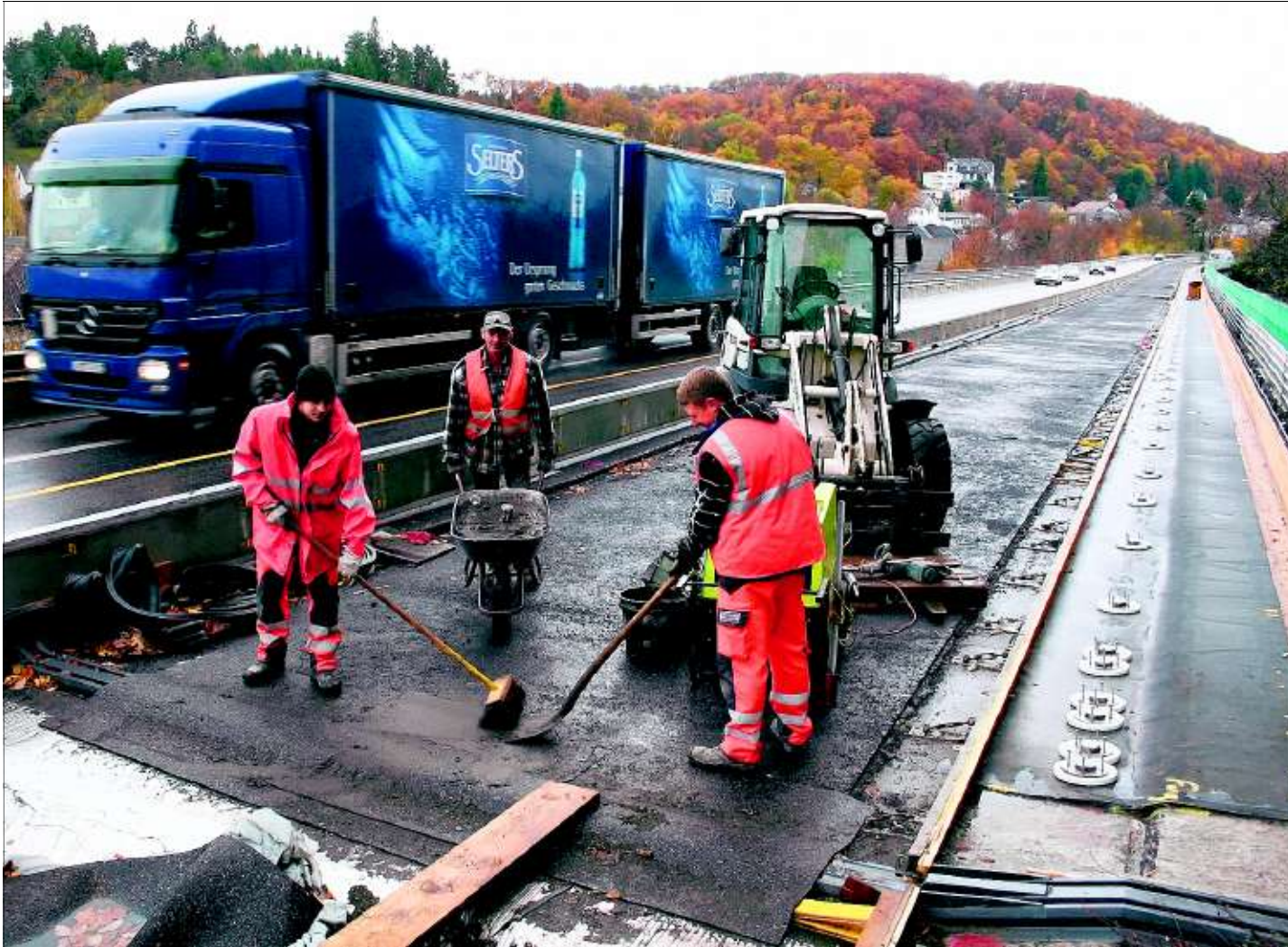
Während rechts auf der B 51-Brücke gearbeitet wird, läuft der Verkehr links in beiden Fahrtrichtungen ohne Probleme. (Foto: Schmitz)
